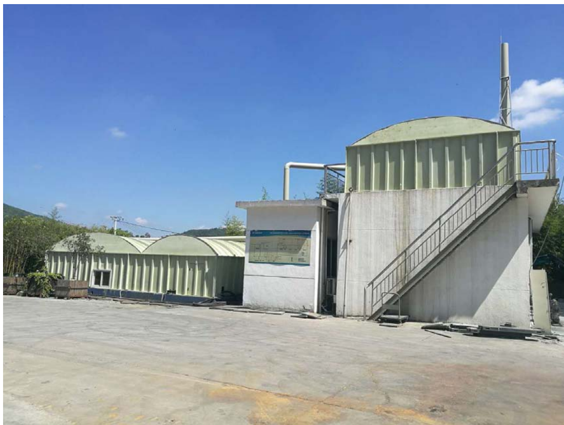
污水处理装置
