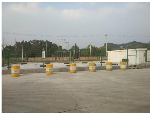
油罐区及排空管
