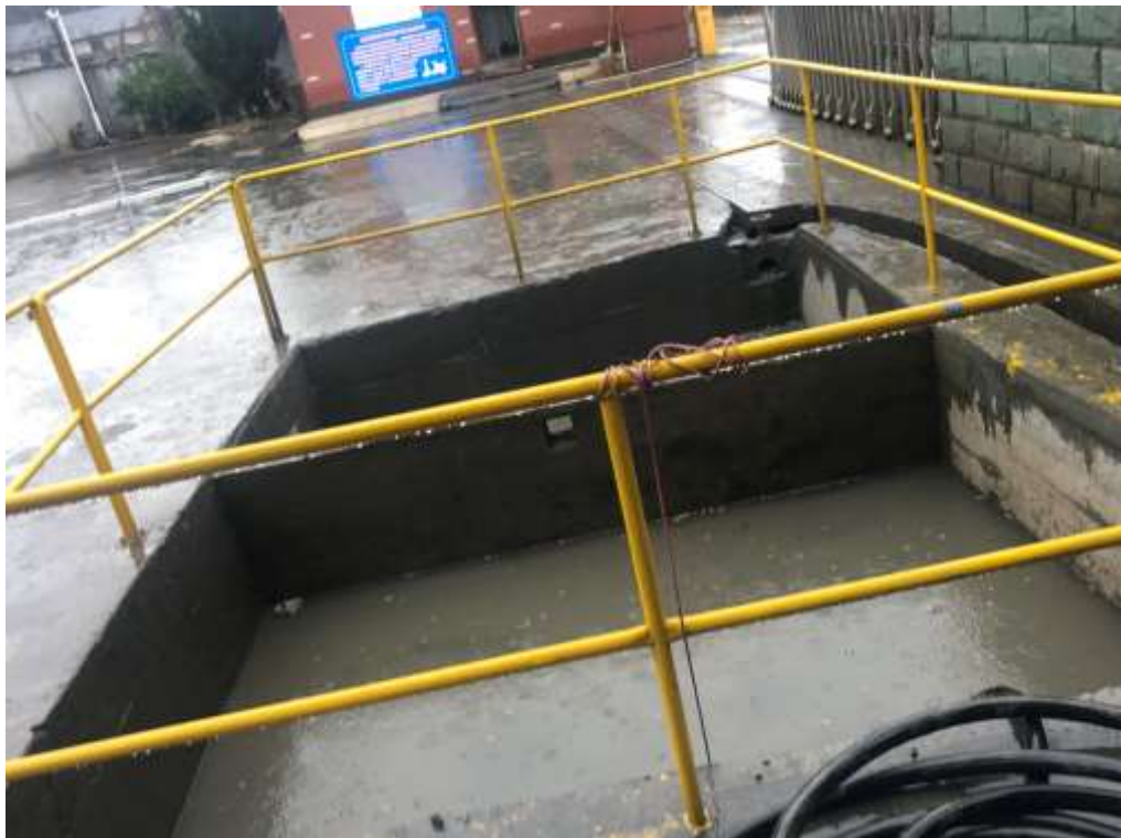
图 3-1 企业雨水收集池
