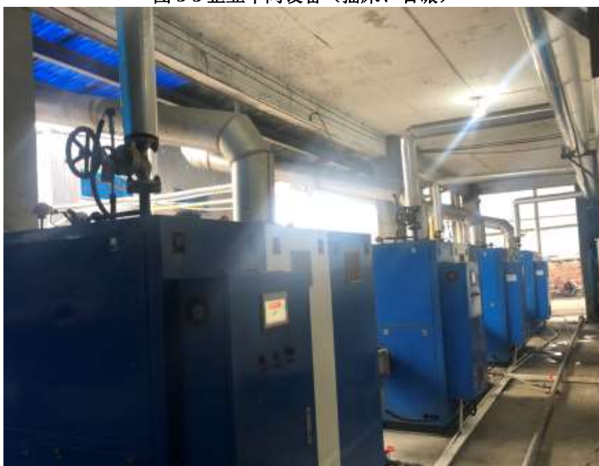
图 3-4 蒸汽发生器（1t）及废气排放口
