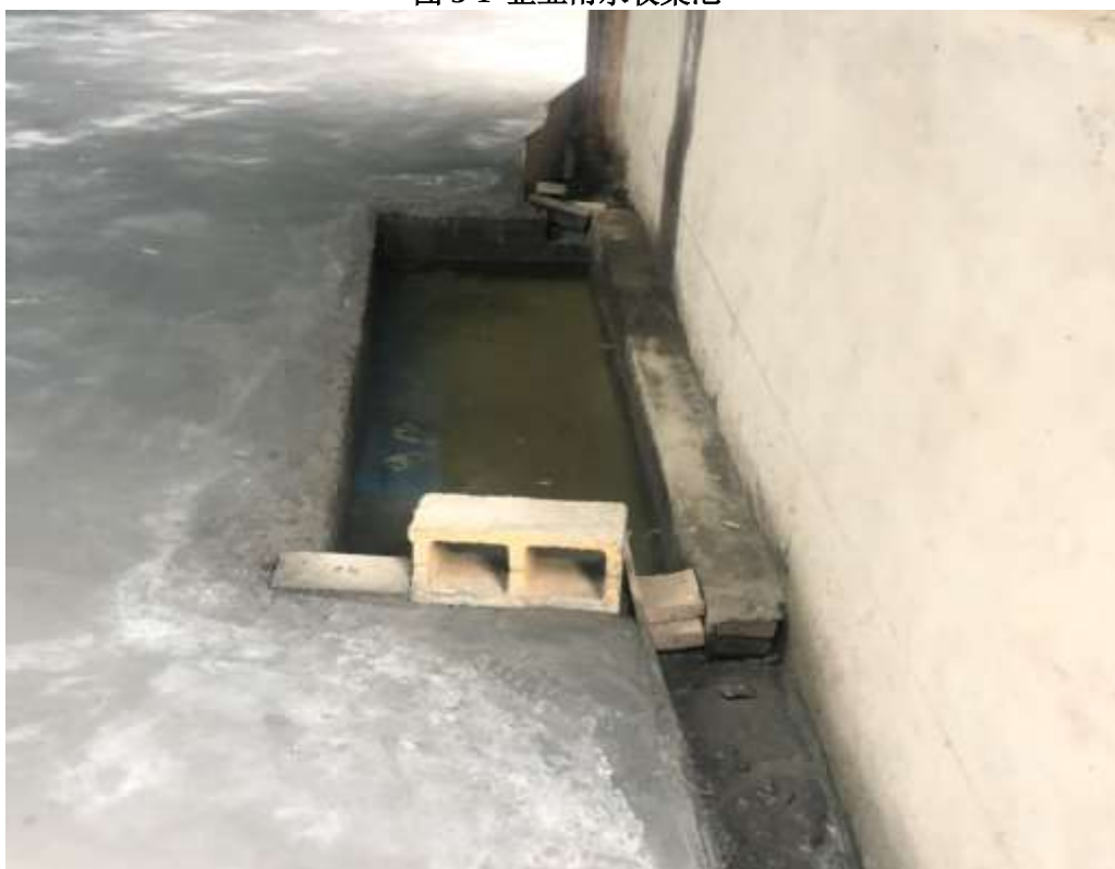
图 3-2 车间清洗废水收集池
