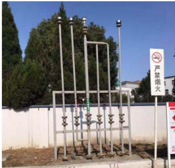
油气回收装置
