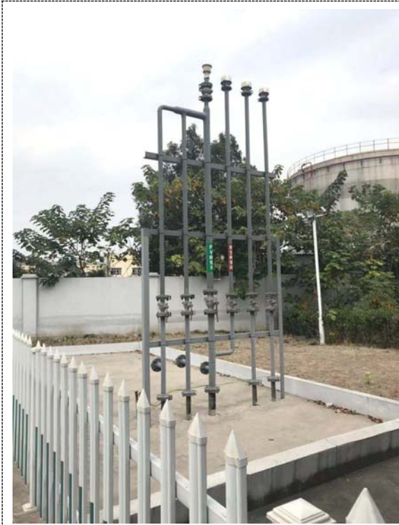
东站区油气回收系统
