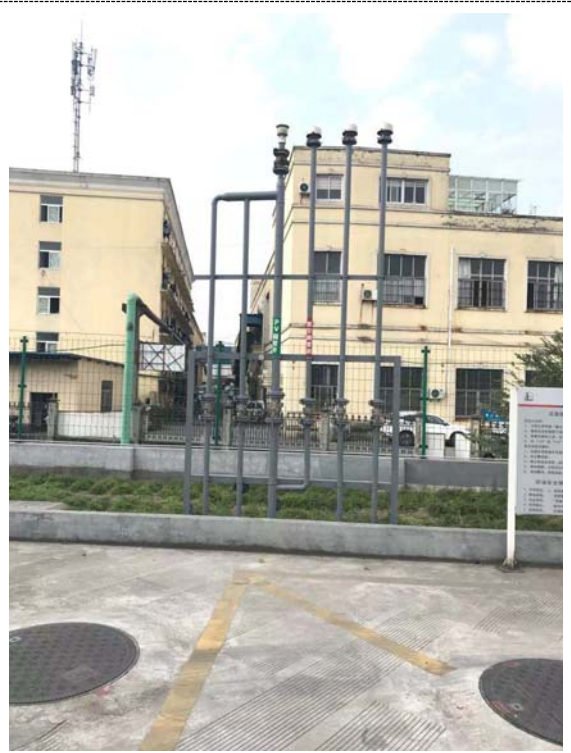
西站区油气回收系统
