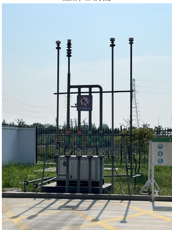
三次油气回收装置
